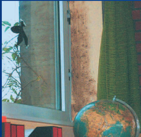
Schimmelbildung vor der Sanierung
