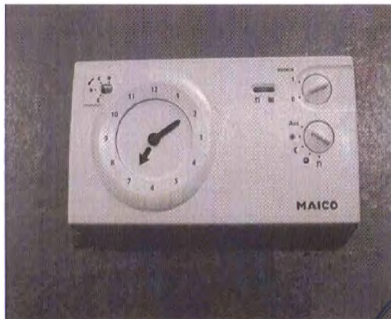
Raumluftsteuerung "RLS 2F" des zentralen Wohnungslüftungsgerätes vom Typ "aeronom WR 300"
